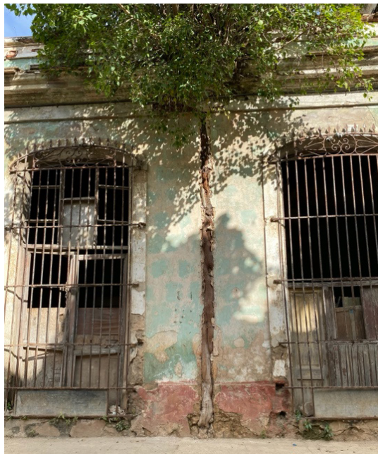
Imagen 5. Árbol que sustituye una columna de madera y recobra un espacio negado por la segunda naturaleza creada durante la Colonia en el municipio Habana Vieja
